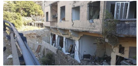
Die Schäden in Beirut erstrecken sich weit über den Hafen hinaus.
